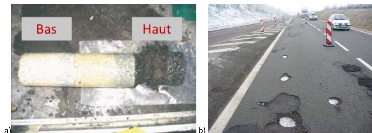
Figure 2-1. Désordres dans une chaussée du nord-est de la France (a) Carotte de la structure de chaussée, (b) Chapelets de nids de poule pluri-décimétriques (Mauduit, et al., 2013)
