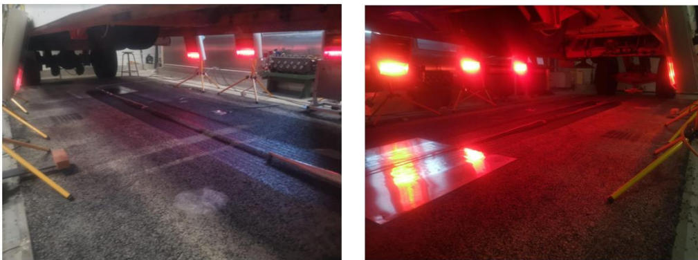
Figure 9 : Système de chauffage infrarouge de la couche surface
